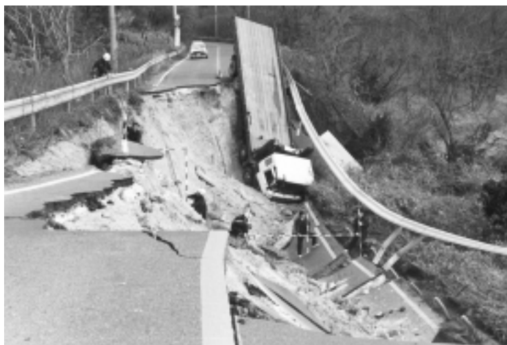
【写真左】 地滑りで崩壊した山道
