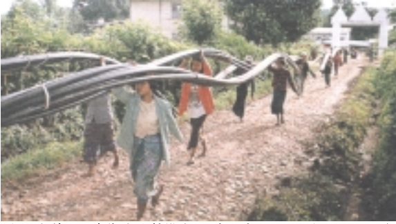
上下水道と公衆衛生を整備するプロジェクト（ミャンマー） 写真提供：Habitat
