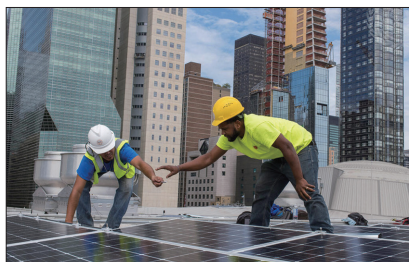
国連本部ビルの屋上に設置されたソーラーパネル
