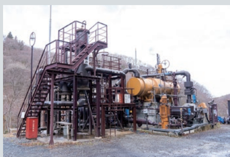
日本が世界第3位の資源量を持つとされる「地熱」を活かした土湯温泉町の発電所(福島県)
